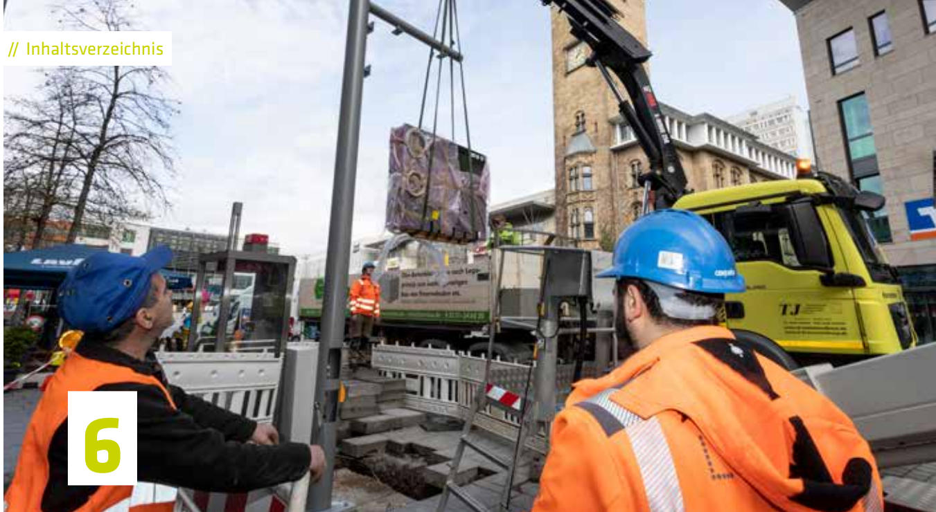
Installation eines neuen Großanzeigers der Hagener Straßenbahn im Zentrum von Hagen. Er informiert – mit zwei weiteren Großanzeigern in der City – über die nächsten Abfahrten und zeigt sonstige wichtige Verkehrshinweise an
